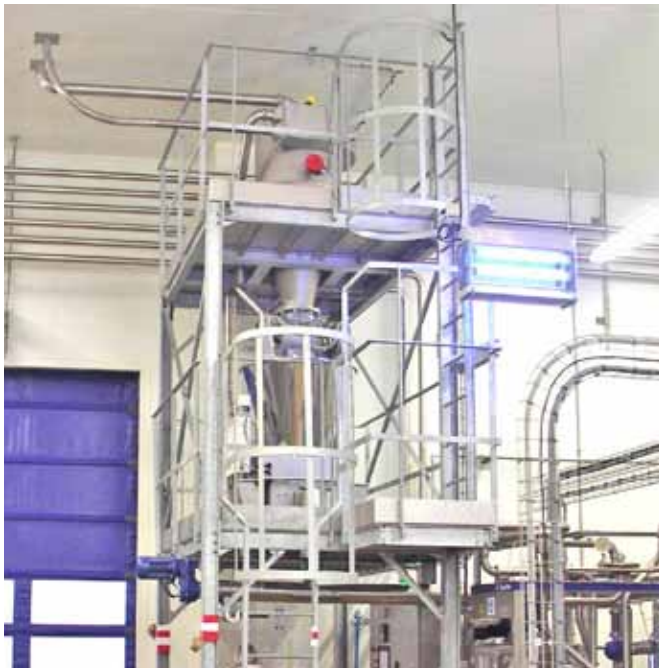
Alimentation de transport pneumatique par cyclone
