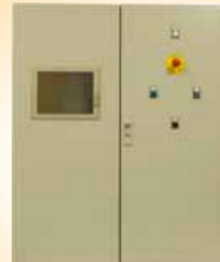
Armoire de contrôle
