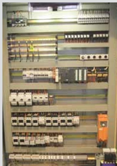
Armoire électrique Stolz
