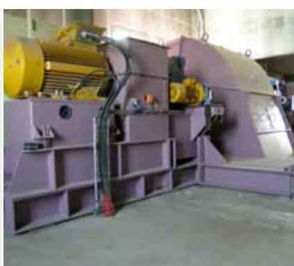
Tête d'élevateur gros débit (1600 m³/h, hauteur 65 m, 2x200 kW)
