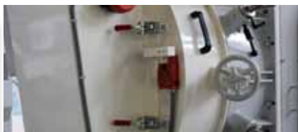
Sécurité sur portes électrique
