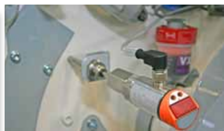
Contrôle de température sur chambre de broyage
