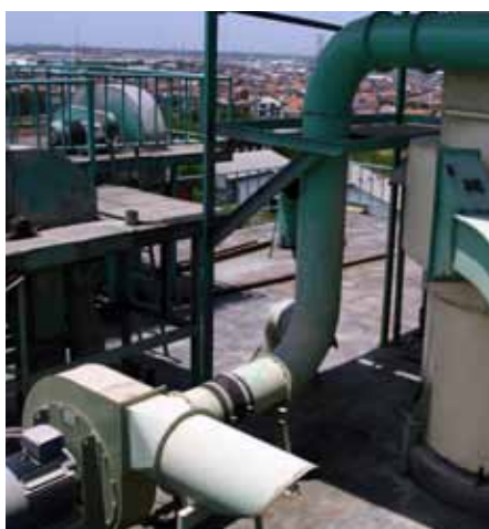
Cyclo-filter and fan
